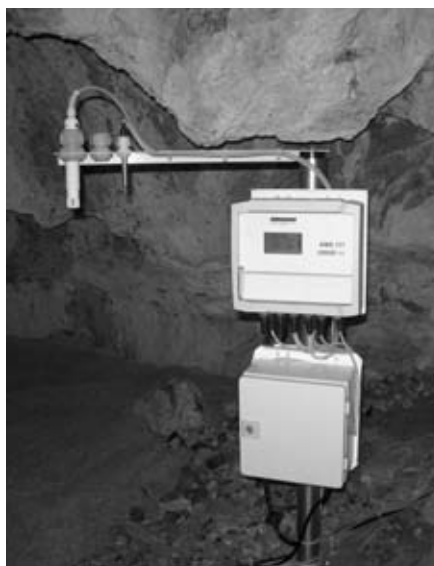
Obr. 2. Monitorovacia stanica so senzormi teploty a relatívnej vlhkosti vzduchu, kontaktnej teploty vzduch/hornina a teploty horniny v hĺbke 0,20 a 1,20 m (Demänovská ľadová jaskyňa, Veľký dóm). Foto: J. Zelinka Fig. 2. Monitoring station with sensors for temperature and relative humidity, contact temperature of air/rock and bedrock temperature in the depth of 0.20 and 1.20 m (Demänovská Ice Cave, Great Dome). Photo: J. Zelinka
